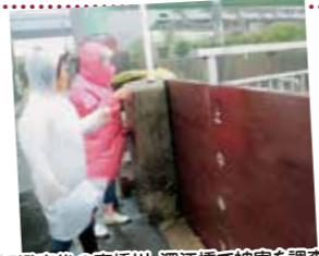
氾濫直後の高橋川・深江橋で被害を調査 (昨年9月4日)
